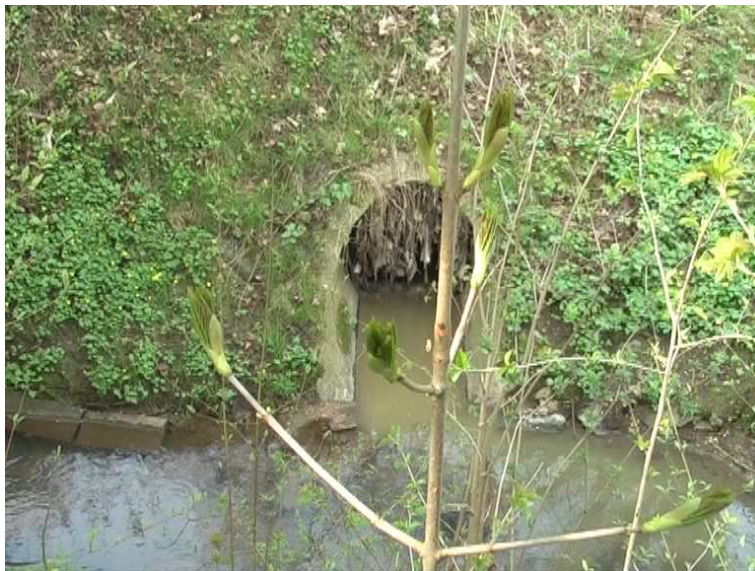
Trockenwetter-Einleitung begleitet mit üblem Gestank nach Fäkalien (Bild vom 7. April 2009)
