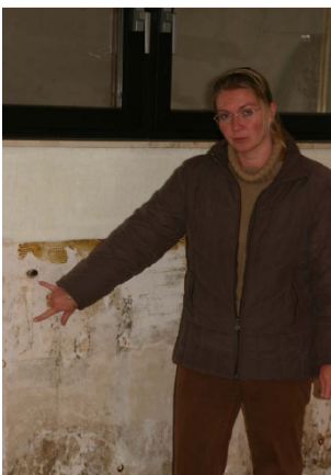
Schimmelpilz an den Wänden,
